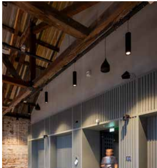
Verdringingsventilatie in een zuil op het vliegveld (links) en achter een houten lattenconstructie in het gemeentehuis van Den Helder.
